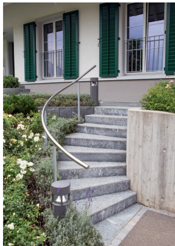
Treppenstufen sollten rutschhemmend und trittsicher ausgeführt sein. Geländer und Handlauf erhöhen die Sicherheit zusätzlich.
